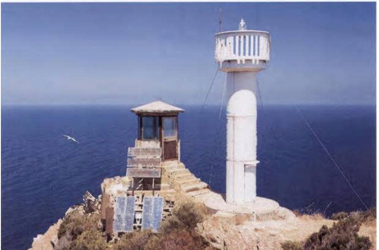
Der Vorgänger: Die Akkus des Leuchtturms von Punta Maestra werden schon lange mit Solarstrom geladen
