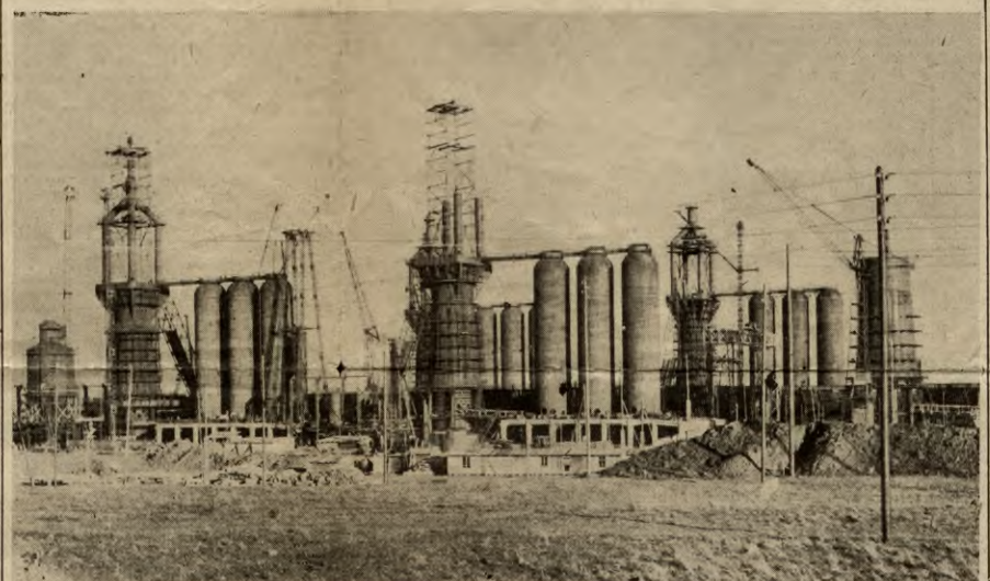
Die „Hütte Braunschweig“ bildet nur einen Teil der Baueinheit im neuen Industriegebiet zwischen der alten Hansestadt und dem Harz. In langer Reihe werden sich die Hochöfen in der Gegend von Watenstedt — Hallendorf erstrecken, schon erhebt sich stolz die erste Hochofengruppe mit den Winderhitzern. (Aufn. Bildstelle der Reichswerke A.-G. „Hermann Göring“)
